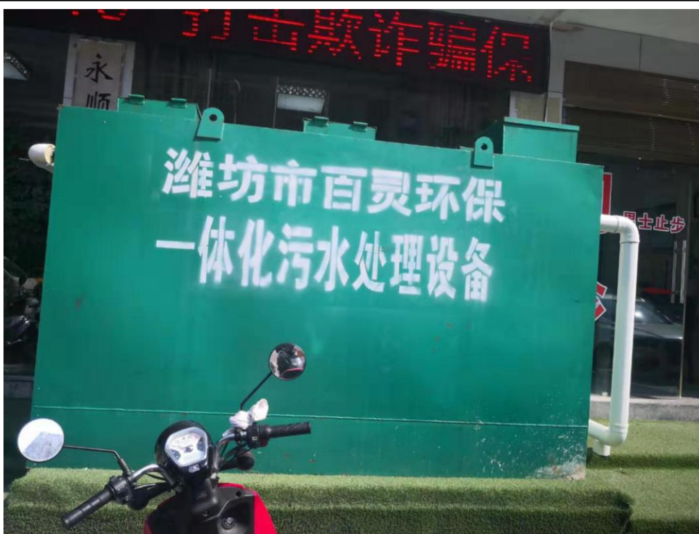
污水处理设施照片
