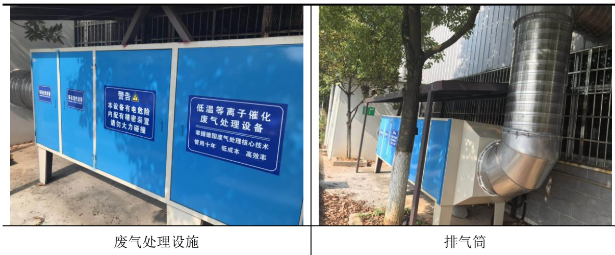
图 4-2 废气处理设施照片
