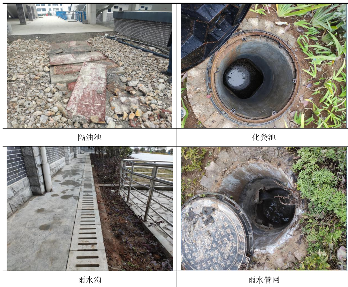
图 4-1 废水处理设施照片
