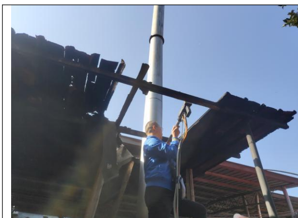
锅炉废气排气筒出口
