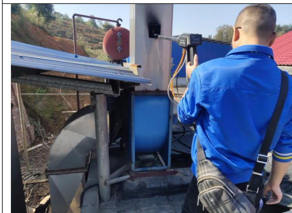
油烟废气排气筒出口
