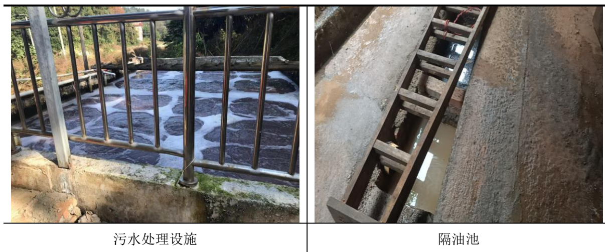
图 4-2 废水处理设施照片
