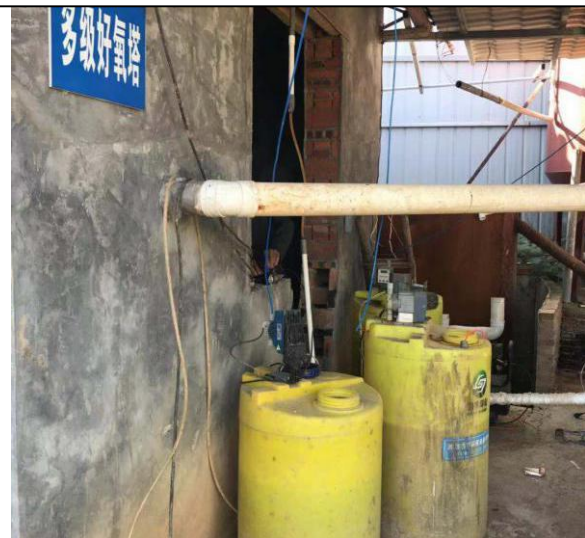
污水处理设施
