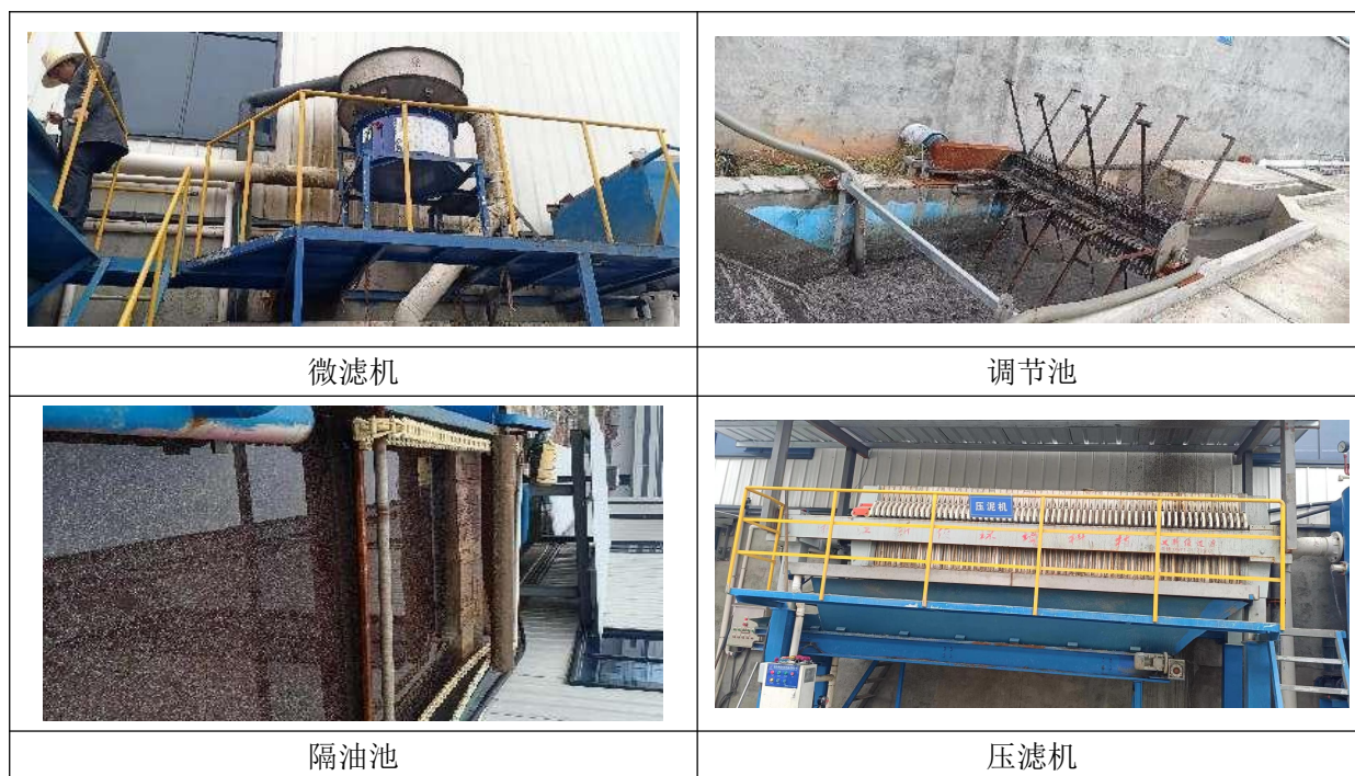
图 4.1-1 项目废水处理设施照片
