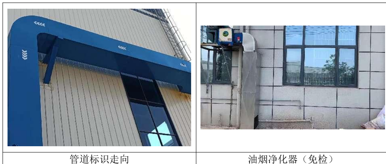
图 4.1-2 项目废气处理设施照片
